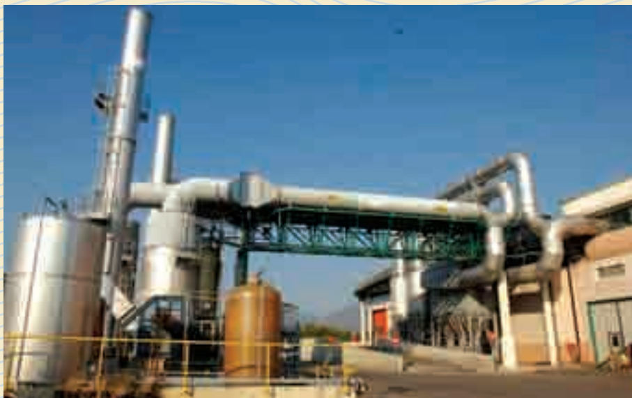
Prato, impianto rifiuti.
